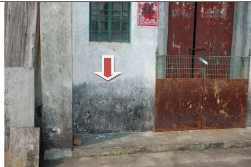
18 號屋水浸痕跡
