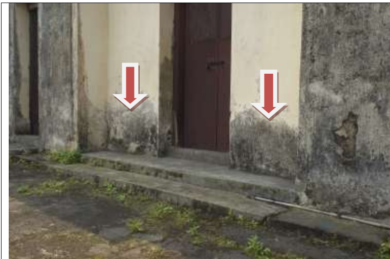
老圍高臺上老屋水浸痕跡
