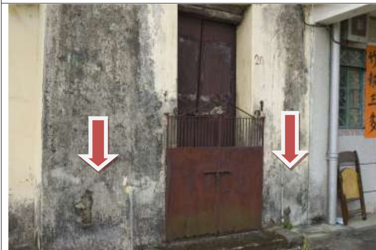
老圍高臺上老屋水浸痕跡
